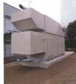
＜震災後導入した発電機＞
